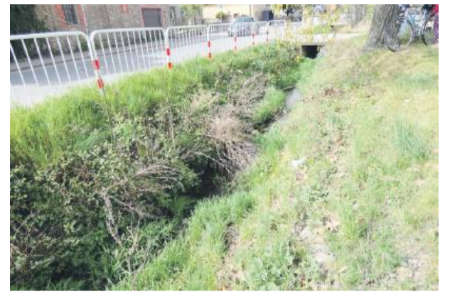
Rów biegnący wzdłuż drogi powiatowej w Gościęcicach pilnie prosi się o wykoszenie i wyczyszczenie
