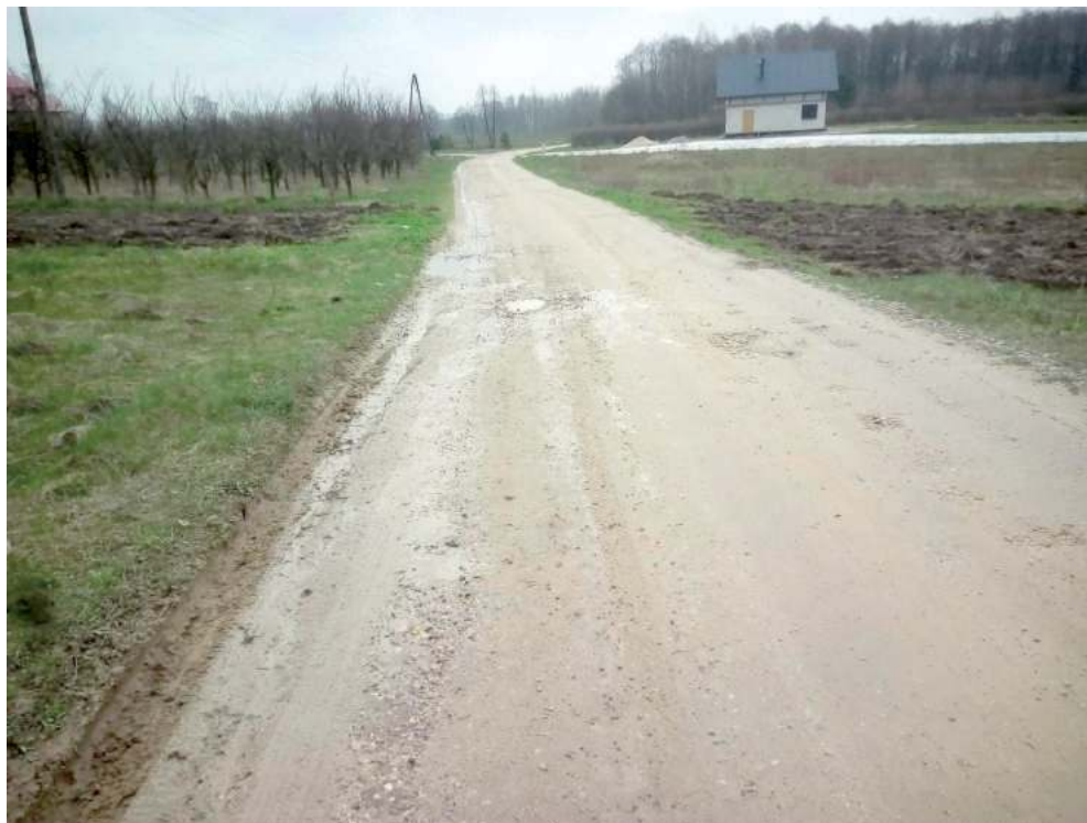
O asfalt na 700-metrowym odcinku gminnej drogi z Przytyk do Wólki Komaszyskiej mieszkańcy walczą od lat. Jak dotąd bezskutecznie
