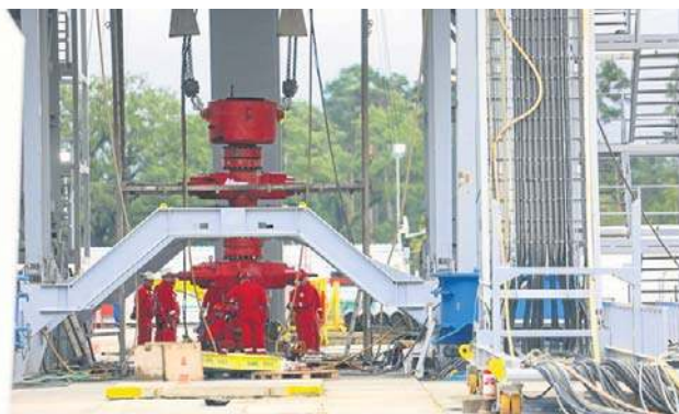
W wyrobiskach, tzw. kawernach, solnych w Kujawsko-Pomorskiem mogłyby powstać podziemne zbiorniki na gaz ziemny. Resort energii jednak tłumaczy, że taki zbiornik powstaje już w dolnośląskich Wierchowicach (na zdjęciu)
