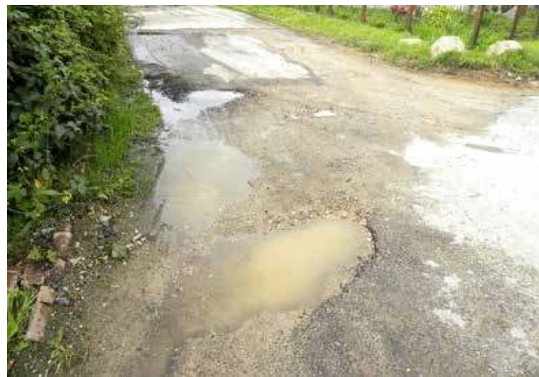
Z 10-metrowego odcinka zostały resztki asfaltu i odwodnienia.
