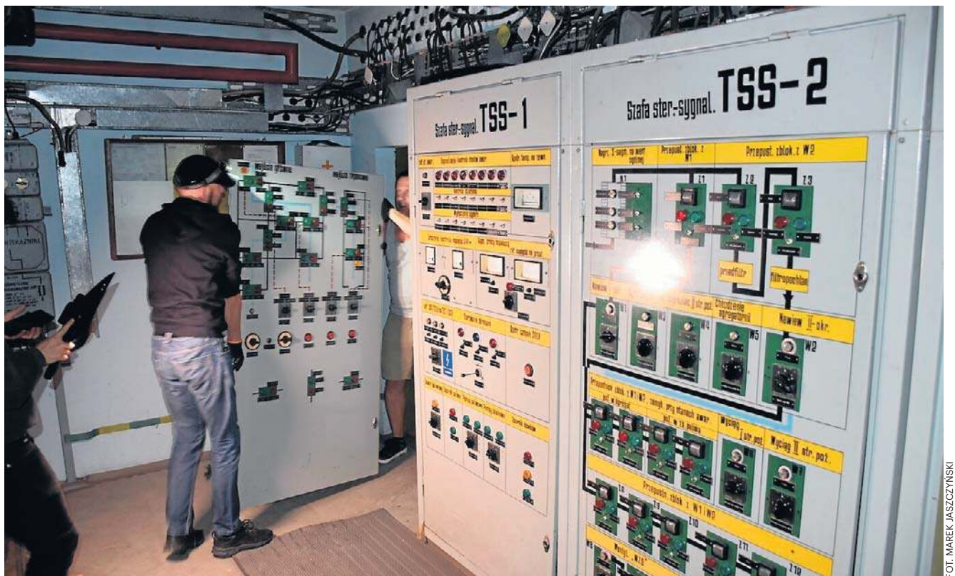
Panele z szafy sterowania, w tym pomieszczeniu sterowano urządzeniami schronu
