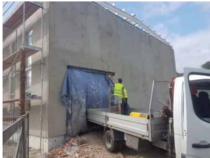
Szczytowe ściany hali trzeba poprawić, mieszkańcy mieli rację
