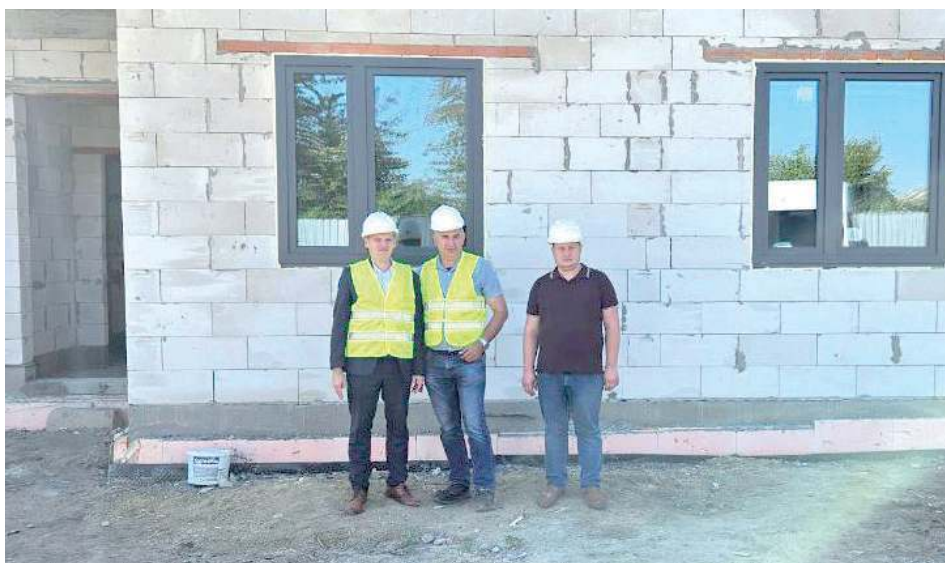
To zdjęcie wykonane zostało we wrześniu br. na budowie przedszkola w Granicach. Wójt (pierwszy od lewej) na nogach, zamiast butów ochronnych, które kupił w grudniu ub.r., ma pantofle... A nas w mediach społecznościowych poucza z BHP
