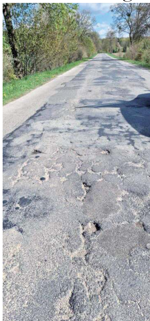
Gołym okiem widać, że remont drogi powiatowej Żabno-Żółkiewka jest pilnie potrzebny
