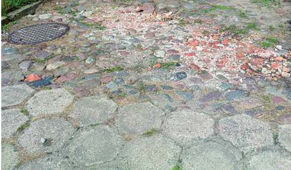
Podwórko na tyłach tego budynku zwyczajnie się zapada, jest jak mówią mieszkańcy tykająca bomba
