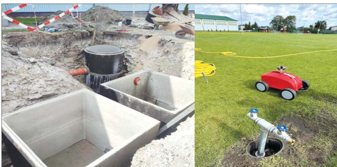
Deszczówka trafia do podziemnych zbiorników, a później służy do podlewania szkolnego boiska.
