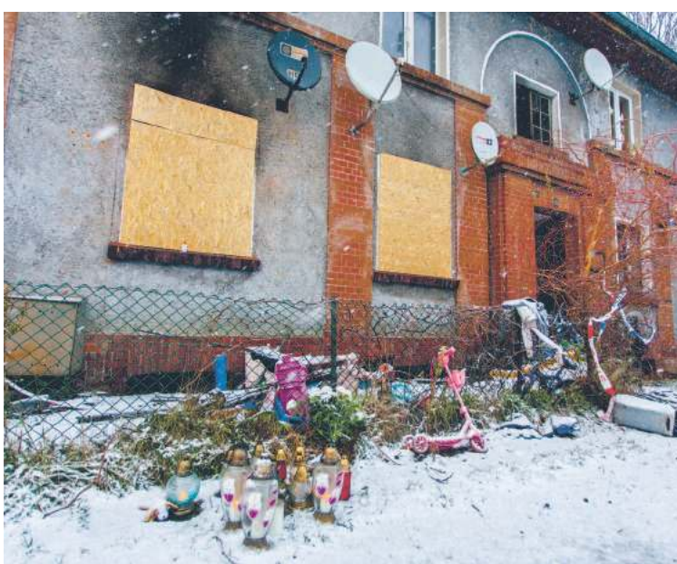
Kamienica, w której w wyniku pożaru zginęło troje dzieci | fot. Ignac Głowacki/Gazeta Polska
