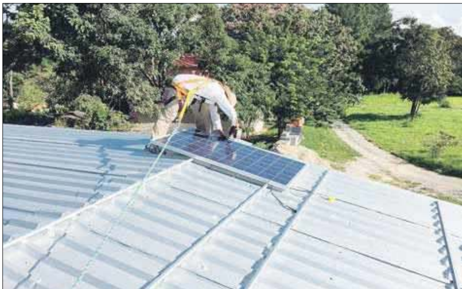
Radna apeluje o sprawdzenie parametrów fotowoltaiki zamontowanej radzynianom w ramach „Słonecznej Alternatywy dla Radzyna” i wytyka nieprawidłowości
