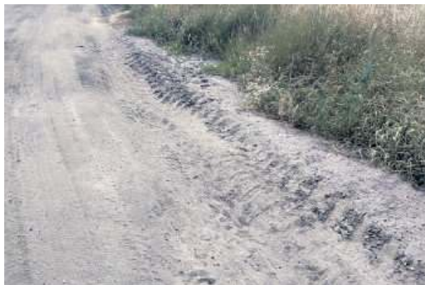
Odcinek łączący ul. Krzepicką ze ścieżką z fotografii obok wymaga interwencji
