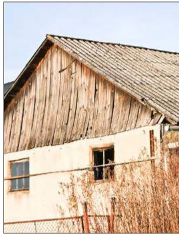
Na dachach budynków w Dębicy jest nadal dużo eternitu.
