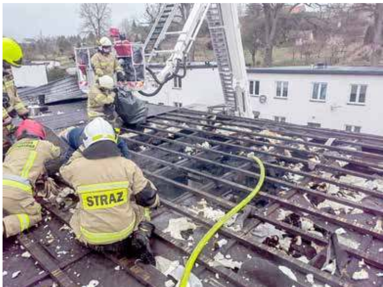
Strażacy oraz osoby pomagające im w gaszeniu pożaru zrywali dachówki (fot. OSP Maszewo)
