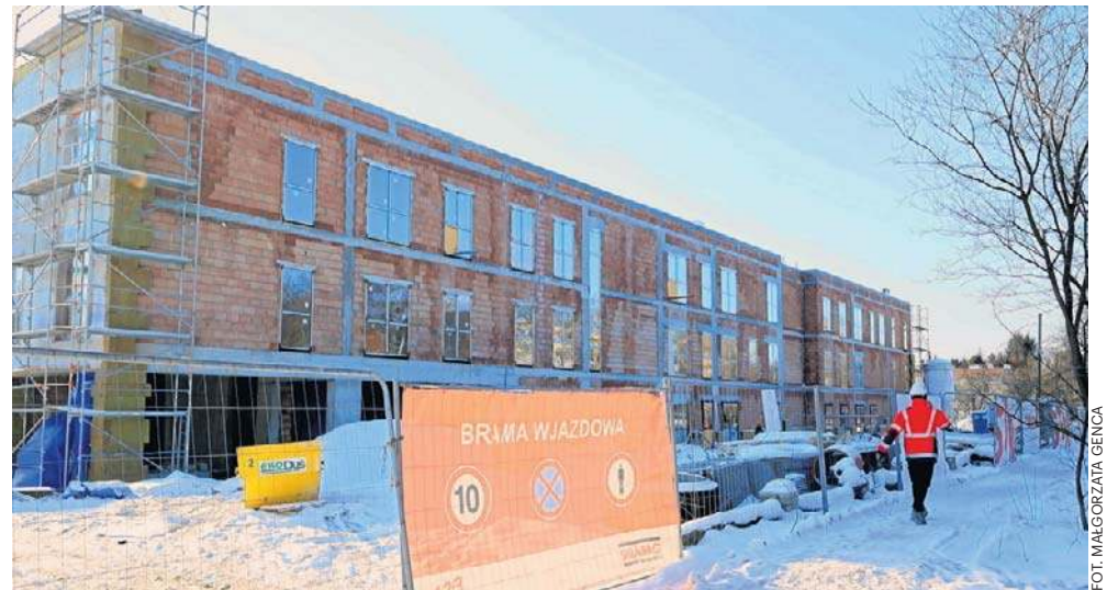
Budowa nowej siedziby dla Szkoły Podstawowej Specjalnej nr 26. Gmach, który powstaje przy ul. Pogodnej 35 jest już w stanie surowym
