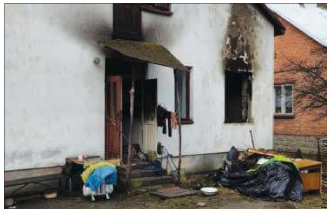
Całe wnętrze wymaga remontu.
