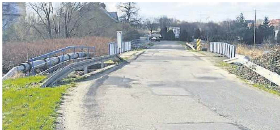
Gmina Strzelin planuje złożyć wniosek o dofinansowanie na przebudowę mostów na ulicy Brzegowej w Strzelinie, które są w złym stanie technicznym
