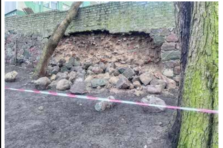
Uszkodzony mur obronny w końcu doczeka się naprawy
