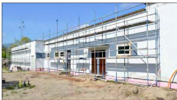
Projekt „Termomodernizacja budynków z zastosowaniem OZE w obiektach edukacyjnych w powiecie ryckim” obejmuje prace w trzech lokalizacjach (fot. ryki.powiat.pl)
