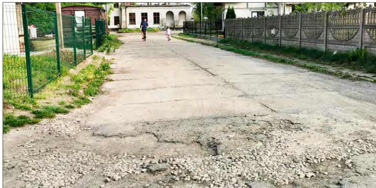
Należąca do PKP ulica Dworcowa w Leopoldowie od dziesiątków lat nie była remontowana. Przejęcie jej przez gminę daje mieszkańcom nadzieję, że nawierzchnia w niedługim czasie zostanie poprawiona
