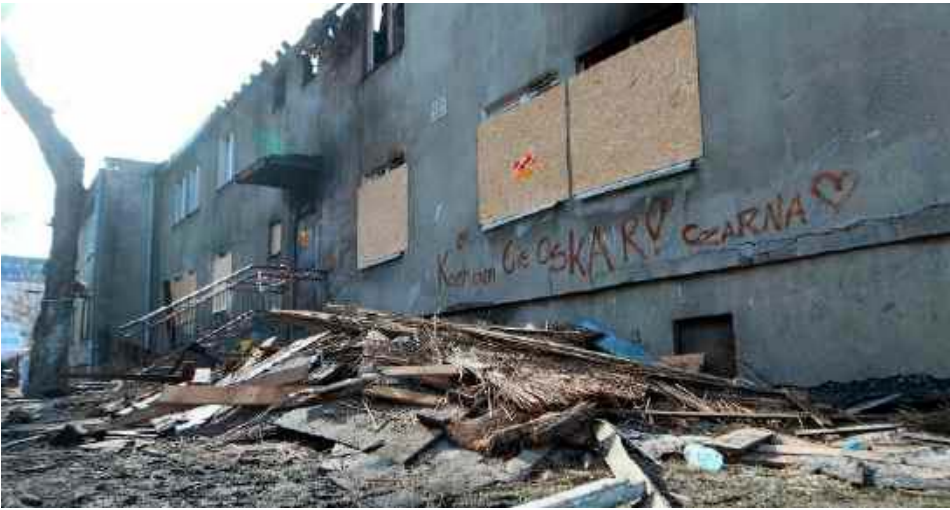
Zrujnowany pożarem budynek nadaje się tylko do rozbiórk
