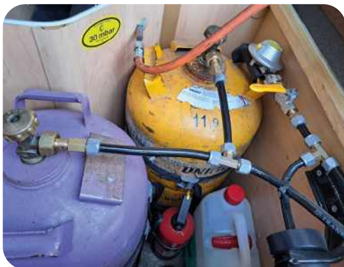
Przykład domoroślej samoróbki klienta – taka instalacja nie przejdzie oczywiście badań szczelności
