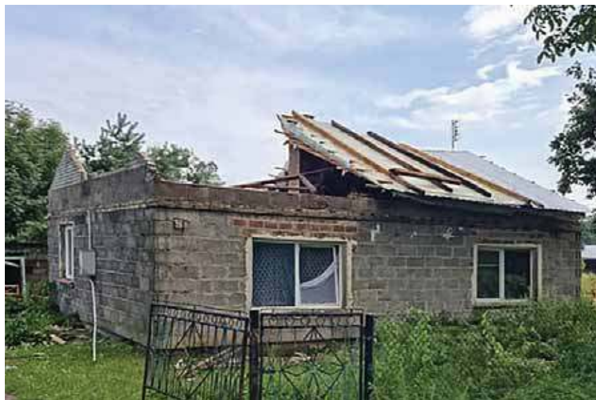
Uszkodzony dom strażaka ochotnika
