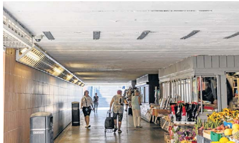
Kluczowe dla ruchu pieszych przejście pod ul. Włotową jest w fatalnym stanie. Miejsce to ma zostać wreszcie zmodernizowane
