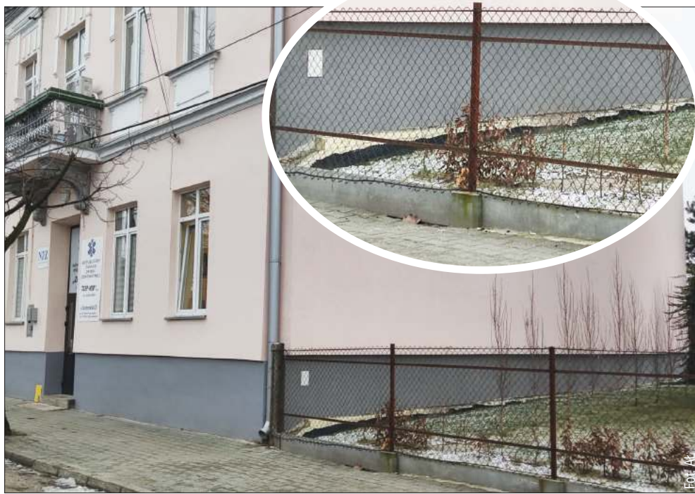
Niedokończone prace elewacyjne powodują nasiąkanie fundamentów oraz niszczenie elewacji.
