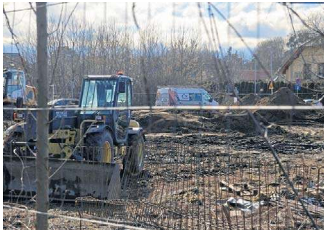
Trwa budowa sklepu w lewobrzeżnej części Torunia - w obrębie ulic Andersa, Kniaziewiczza i Sinorackiej
