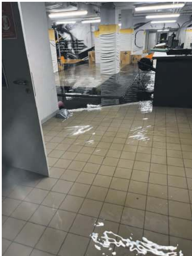
Zalana siłownia na trzebnickim basenie
