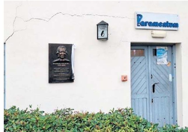
Duże spekanie na budynku powstało na przełomie października i listopada
