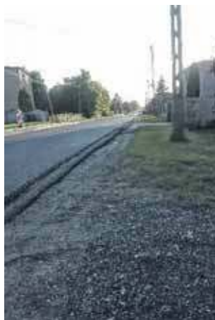
Mieszkańcy mają sporo wątpliwości co do jakości wykonania prac przy ul. Głównej w Zendku FOT. DZIĘKI UPRZEJMOŚCI A. WYSZYŃSKIEGO
