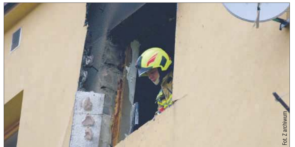
Siła wybuchu była ogromna. Szkło z okien wylądowało kilkadziesiąt metrów dalej, a elewacja uległa zniszczeniu.
