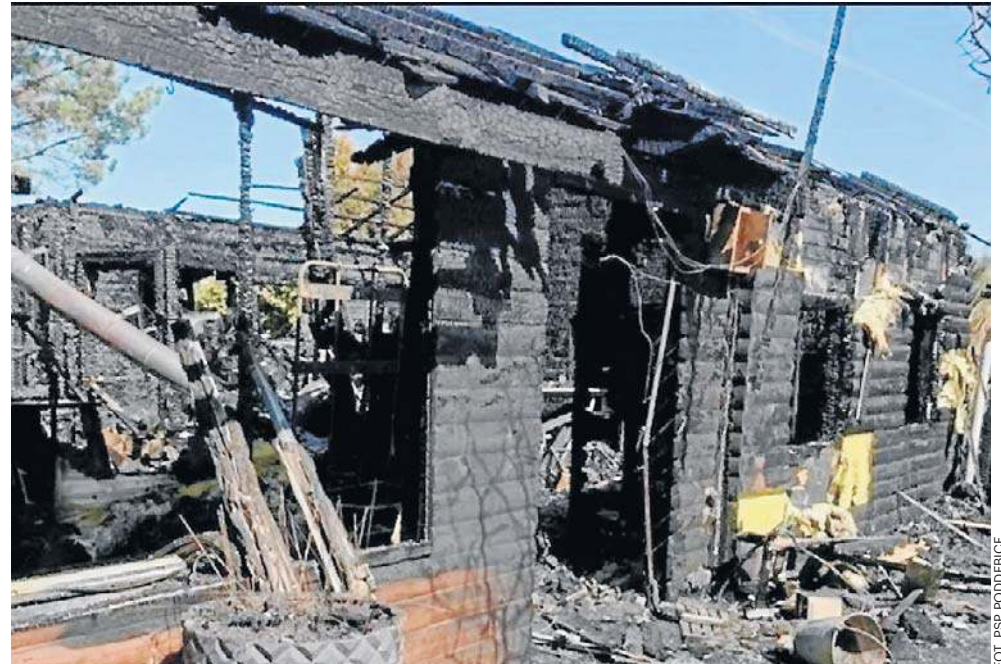
Po pożarze 31 marca dom nie nadaje się już do zamieszkania - jedynym rozwiązaniem jest jego rozbiórka
