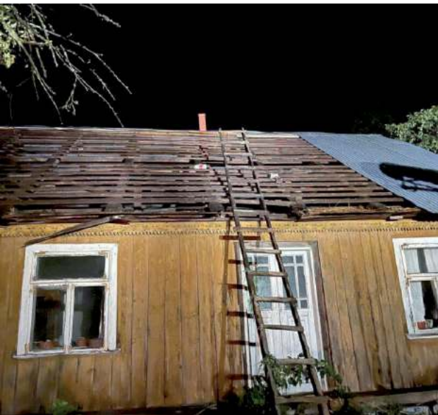
Zerwany dach na domu w Osuchach
