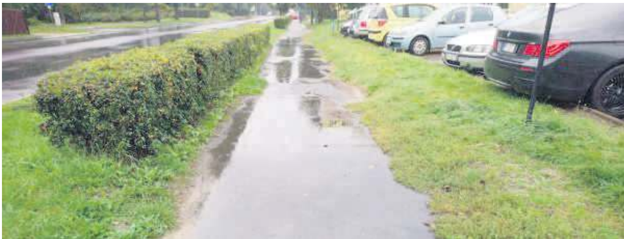
W deszczowe dni na podziurawionym chodniku tworzą się wielkie kałuże. Część pieszych omija je, idąc ulicą.
