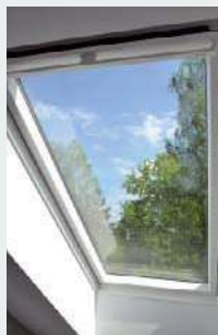
❶ W łazience, nad wanną, znajduje się okno z ramami z PVC.
