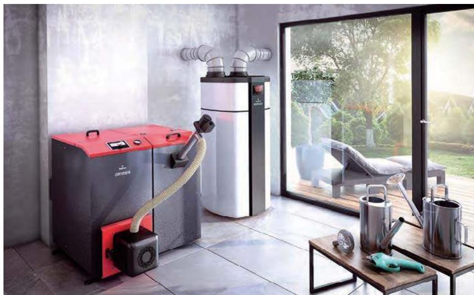
🔌 W sezonie grzewczym c.w.u. podgrzewa kocioł. Natomiast w cieplejszych miesiącach robi to pompa pracująca na powietrzu zewnętrznym. GALMET
