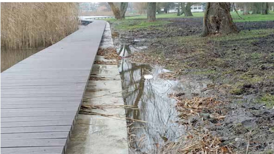
Tuż przy nowej budowlu, zaraz po większej ulewie, zalegają sporej wielkości kałuże wody
