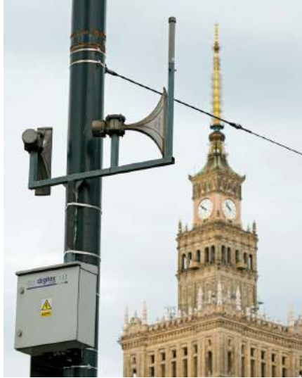
Syrena alarmowa w centrum Warszawy
