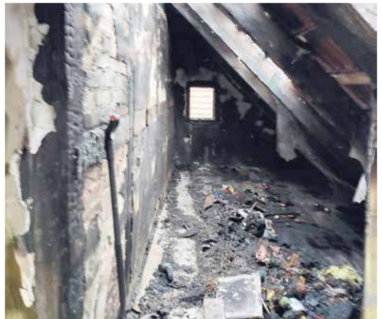
W tym pomieszczeniu wybuchł pożar, jak widać jest ono do kapitalnego remontu
