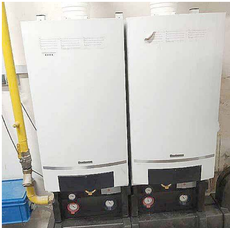
Nowoczesne kotły kondensacyjne to serce nowej i bardziej ekologicznej kotłowni w SP w Dębicach
