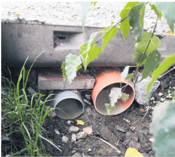
Tak wyglądają niektóre przepusty pod wjazdami na posesje robione przez samych mieszkańców. Dzięki temu unikają zalewania przez wodę płynącą po drodze
