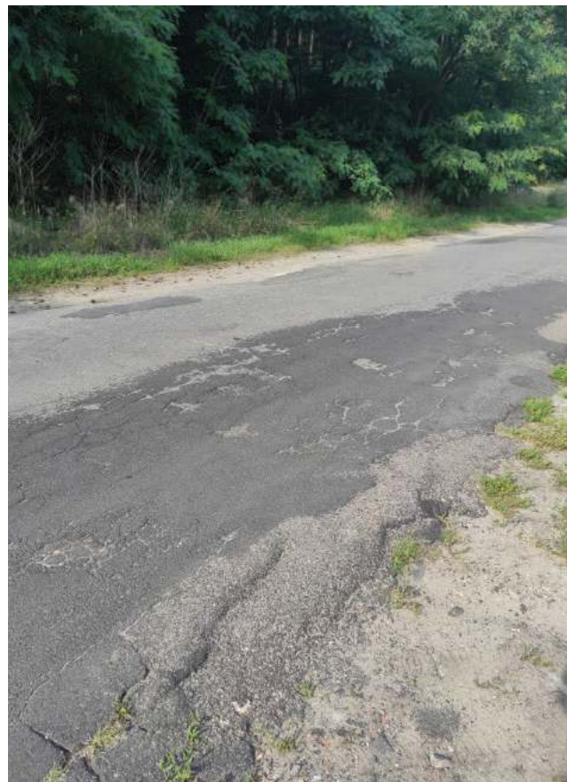
Na odcinku Stara Dąbrowa-Górki trudno znaleźć fragment drogi bez zarzutu
