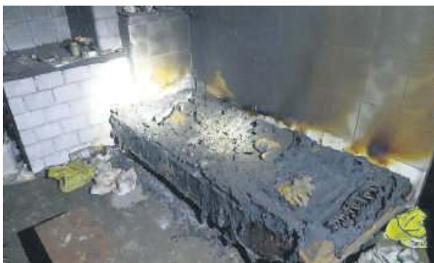
Pożar był niewielki i zgasł samoczynnie. Zniszczony został materac na łóżku, a ściany okopcone.
