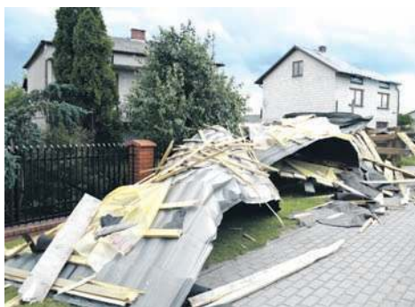
Dach niesiony siłą wiatru w czasie nawałnicy 29 czerwca
