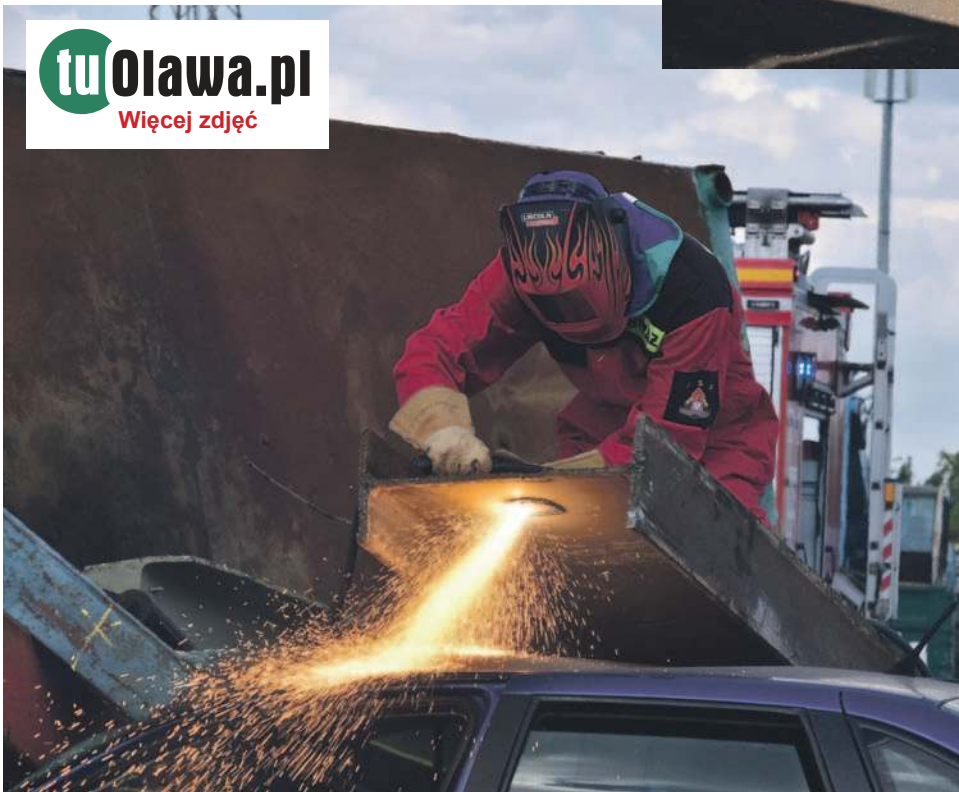
Konieczne było cięcie stalowych elementów, które spadły na samochód osobowy
