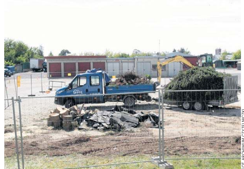
Tu stanie magazyn przeciwpowodziowy, przesłoni świat lokatorom bloku przy ul. Korczaka w Mielcu
