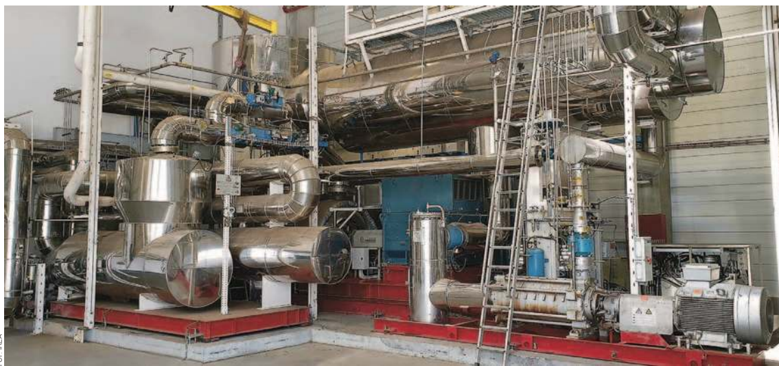
W stalowowolskim tartaku zainstalowano turbinę parową o nominalnej mocy produkcyjnej 1,2 MW energii elektrycznej
