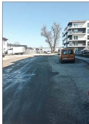
Mieszkańcy chcą remontu tej drogi.
