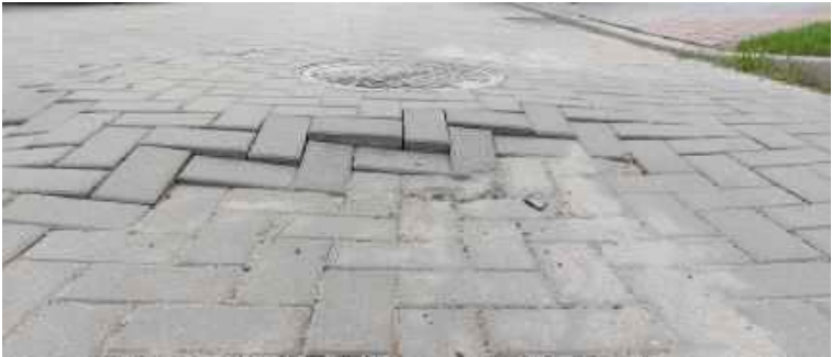
Zapadnięta kostka stanowi dla kierowców niebezpieczną przeszkodę
