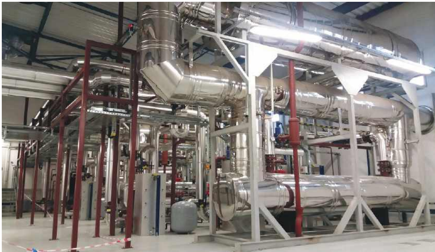
Odzysk ciepła z kogeneracji
