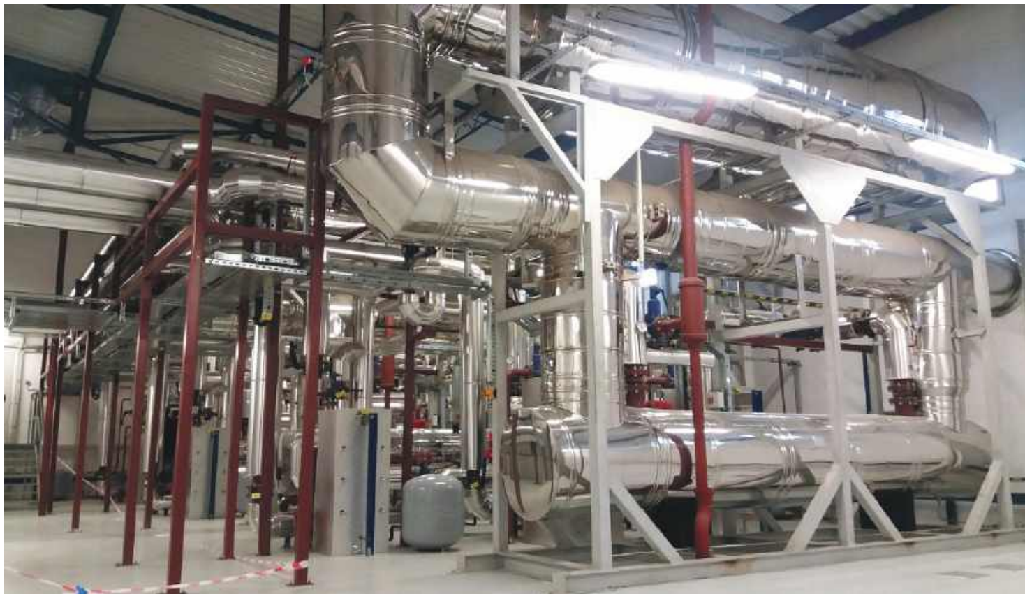
Odzysk ciepła z kogeneracji
