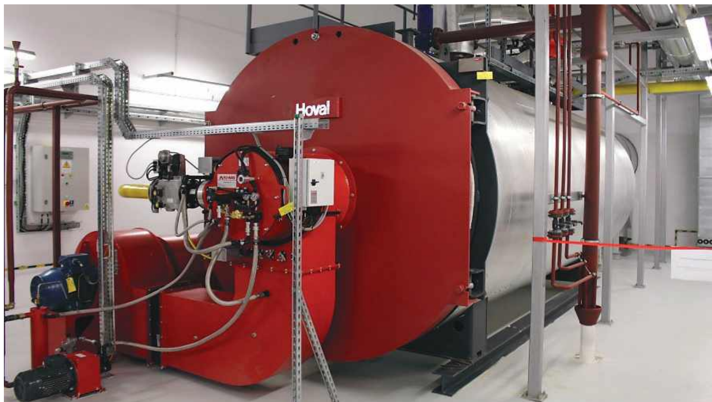
Kocioł szczytowy gazowo-olejowy
