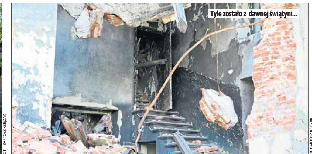
Budynek zawalił się w 2024 r.
