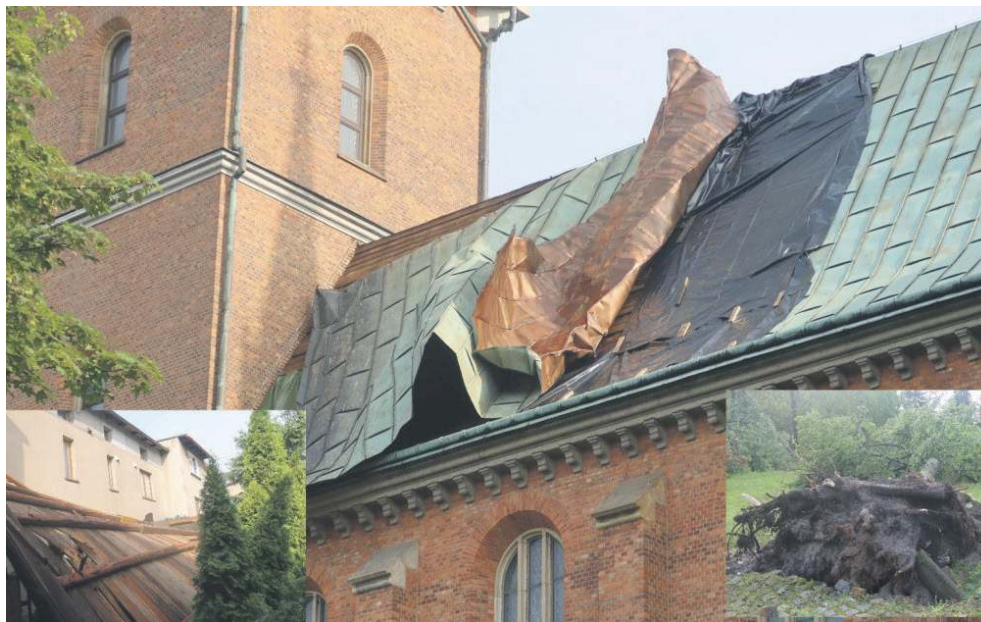
Uszkodzony dach trzebińskiej bazyliki
