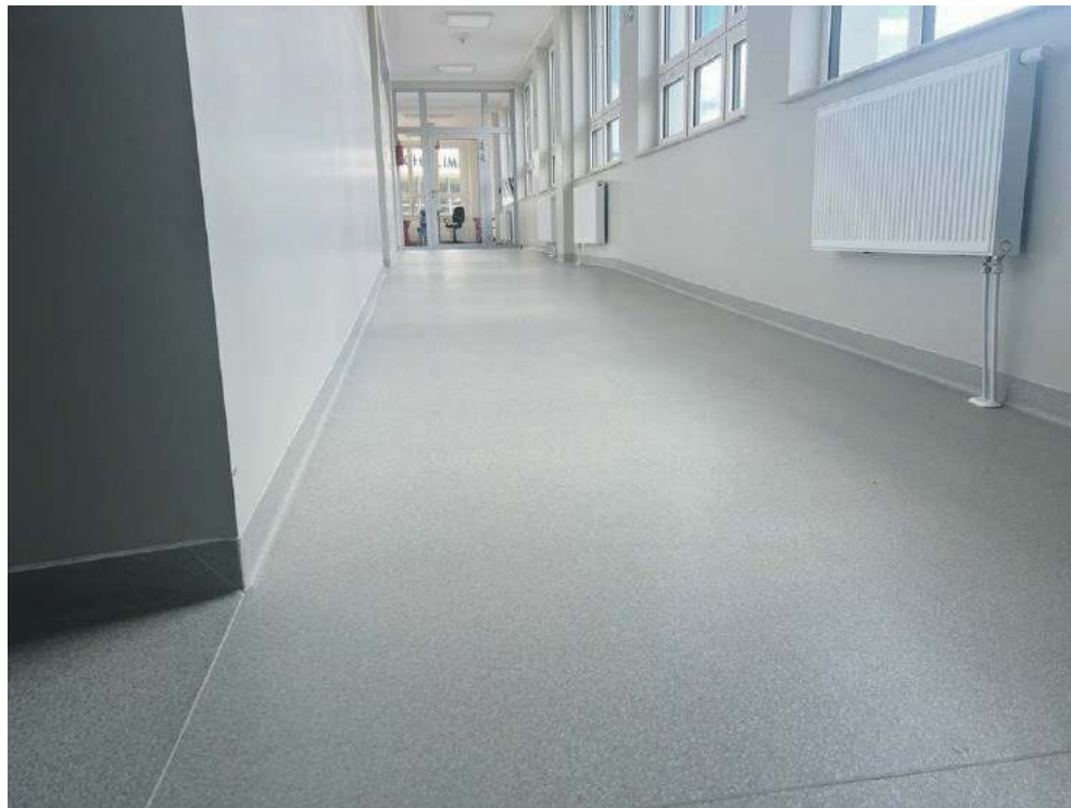
Krzywe korytarze w nowym budynku wyglądają, jakby robiono je w czasach Barei
